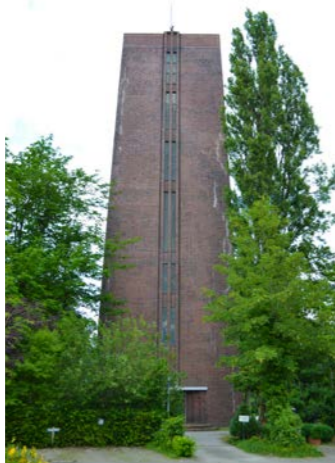
Der Wasserturm: Dringend sanierungsbedürftig
